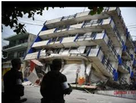
FIGURA 3. EDIFICIO EN CONCRETO REFORZADO CON UN COMPORTAMIENTO NO ADECUADO.
